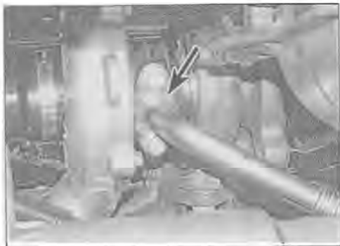
Рис. 9.102 Соединение возвратного маслопровода турбоагнетателя с блоком цилиндров
